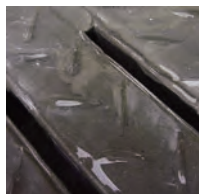
スリット孔からの排水状況
