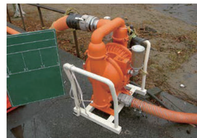
エアハートポンプ外観
